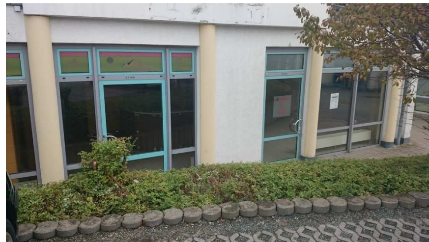
Foto 31: Leerstände im NVZ „Am Bendelstein“
