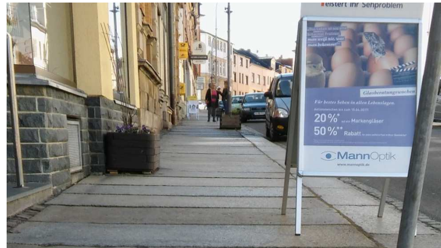
Foto 33: Unebene Gehwege in der Hauptstraße
